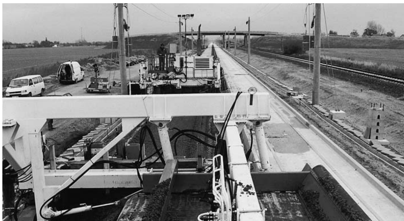
一連の舗設機械の光景：サイドフィーダーの後方にある油圧シリンダーでチェーンコンベアベルトを希望する位置に移動出来る様になっている構造が良く判る。
