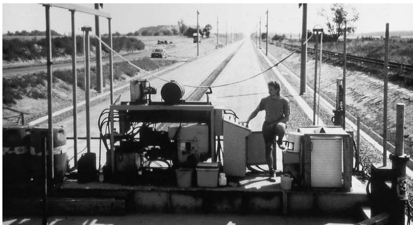
直線距離 600m~780m の舗設を 10 時間のシフトで施工。最大はコンクリートミックスプラントを現場に設置して 1 日 2 シフト（昼間及び夜間夫々 10 時間のシフト）で 1,500m を施工。
