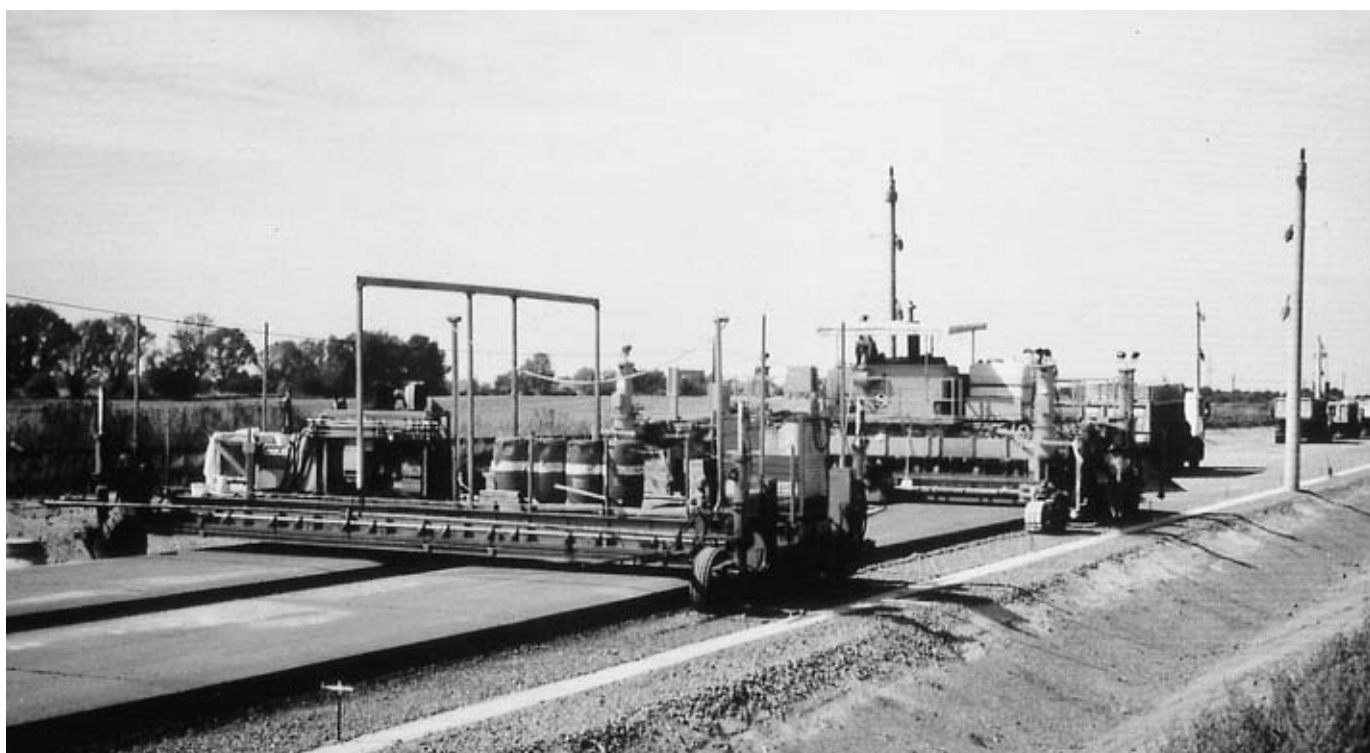
通常道路建設に使用される表面処理機をリーコンクリートの養生剤散布に使用。
